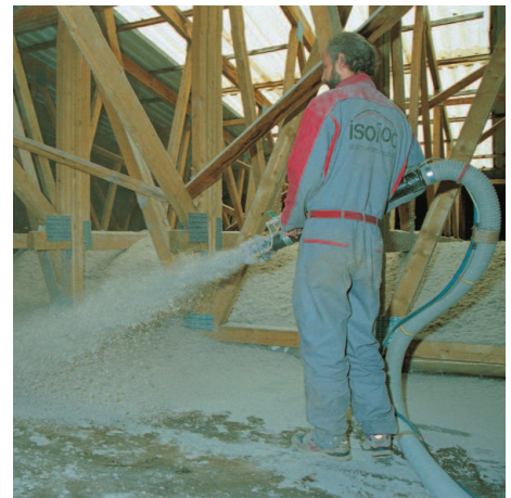
open blazen van isofloc cellulose isolatie op een ongebruikte vloer met de 'terminator'
